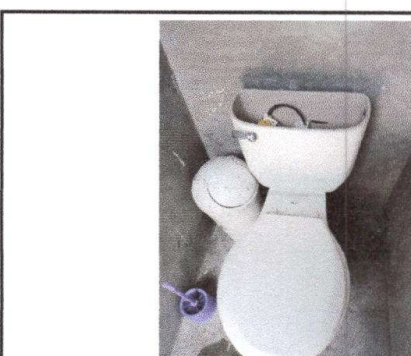
Foto 4: Accesorios de inodoro en mal estado
