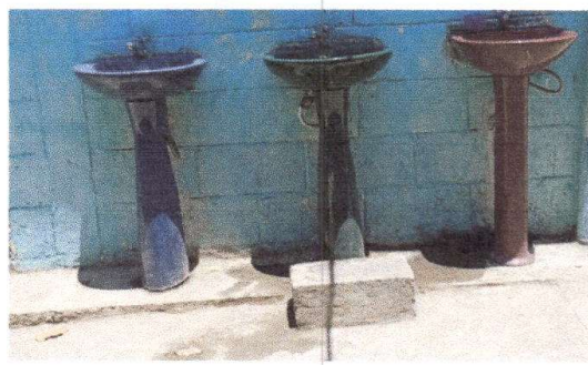
Foto 8: Sustrucción de lavamanos en mal estado
